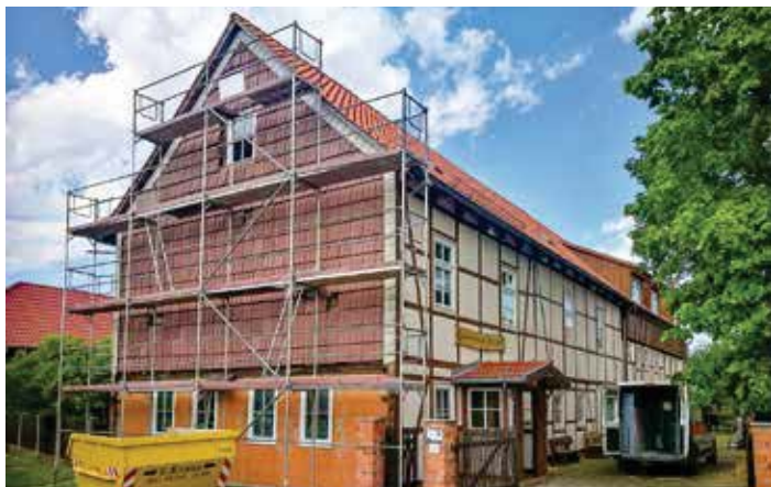
Der Westgiebel ist eingerüstet und bereit für den neuen Wandbehang und Wärmeisolierung Fotos: ©Jörg Niemann
