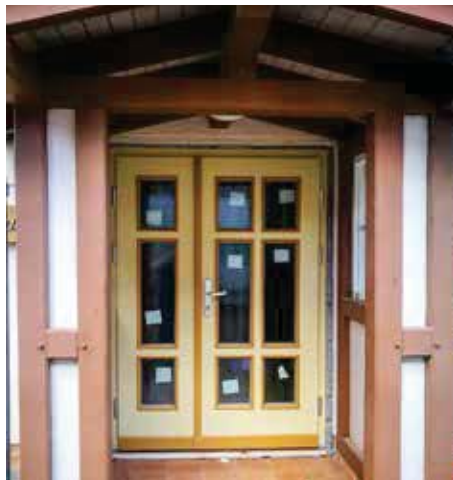
Eine neue Eingangstür zielt nun den hinteren zweiten Eingang zum Museum. Sie sorgt für mehr Sicherheit und Wärmedämmung.
