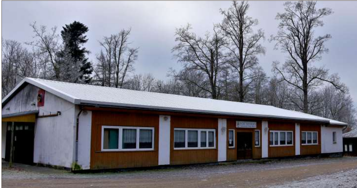
Das Dach des Schützenhauses in Stiege ist im Rahmen eines Leader-Projekts saniert worden.
