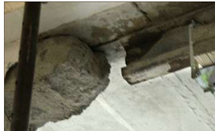
Die Ursache des Problems: Mitten im Raum hört der T-Träger zur Stabilisierung auf. Ein Fall für den Statiker.
