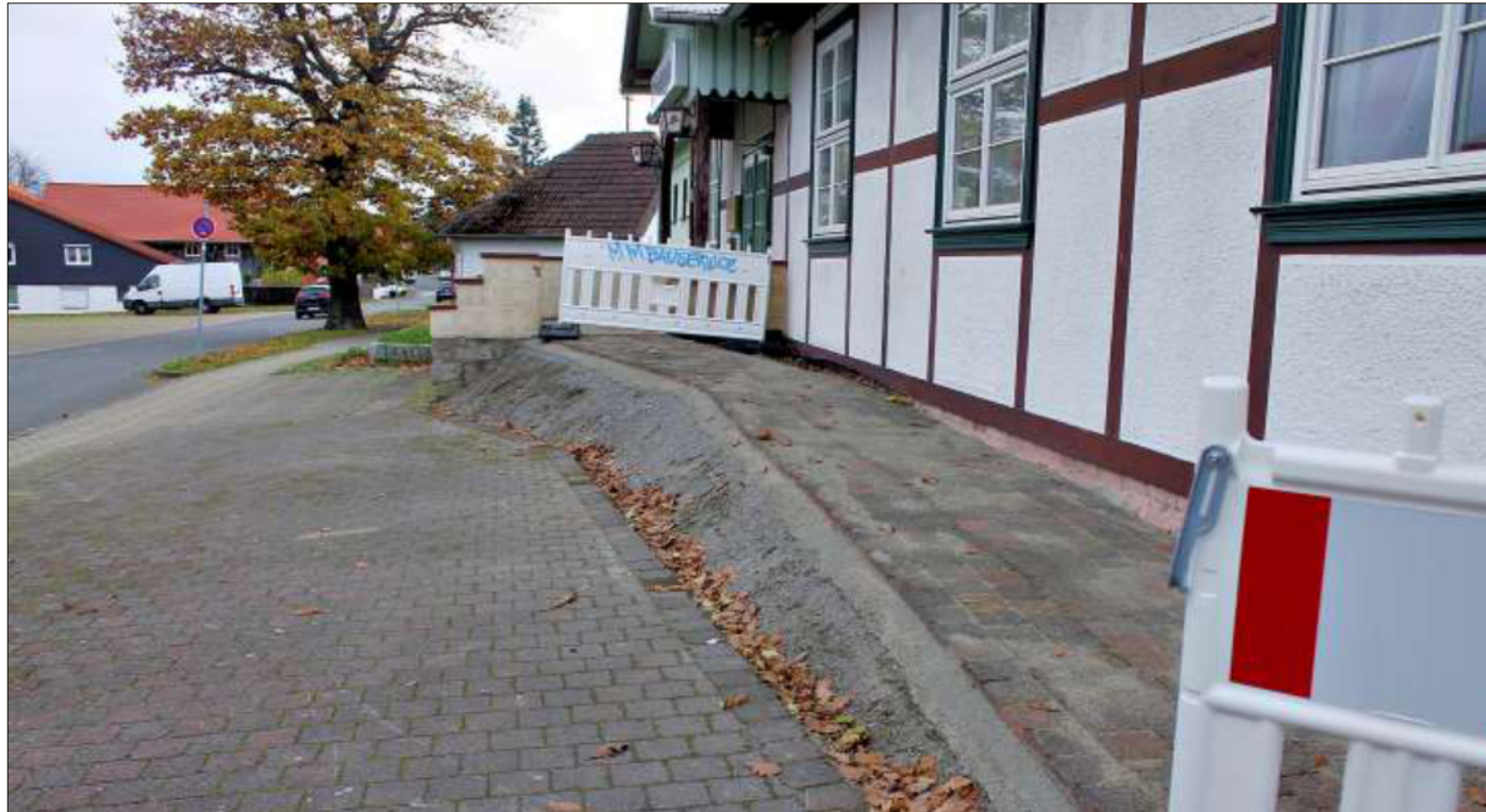
Die künftige Rampe an der Vorderfront des Stapelburger Schützenhauses ist zur Hälfte fertig. Ein Geländer fehlt aber noch immer. Warum es nicht weiter geht, wusste der Ortsbürgermeister auch nicht.
