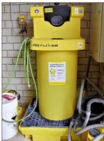
Für die defekte Chlor-Dosierungsanlage ist Ersatz geliefert worden.
