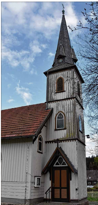
Vor der Reinigung: Am Turm der Holzkirche Elend hat sich über Jahrzehnte hinweg ein Belag gebildet, ...
