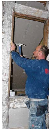
Thomas Löhr von einer Firma aus Wienrode richtet im Dachgeschoss Wände für ein künftiges Archiv ein.
